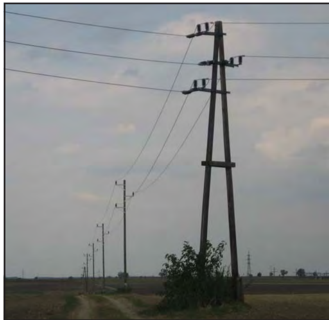
Derartige Stromleitungen gibt es in Wohngebieten nicht mehr.
