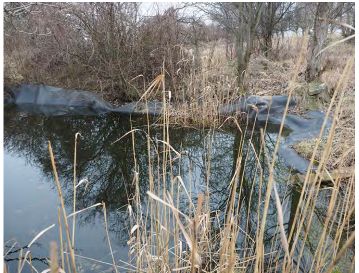
Im Bild der sanierungsbedürftige Teich
