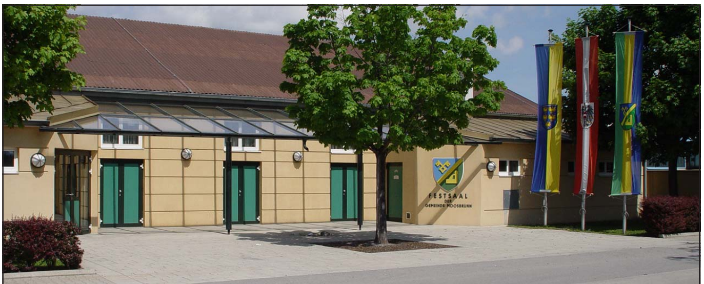
Im Zuge der Straßenbauarbeiten am Gewerbering werden auch neue Autoabstellplätze für Festsaalbesucher geschaffen
